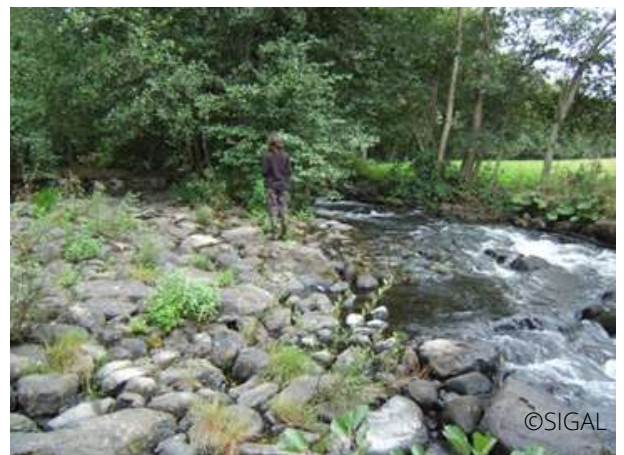
Ouvrage en ruine du moulin de Celles, où un projet de centrale hydroélectrique débute
