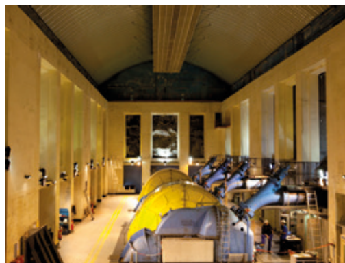
Salle des machines
