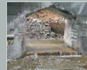
Le pied du barrage percé en 2005
