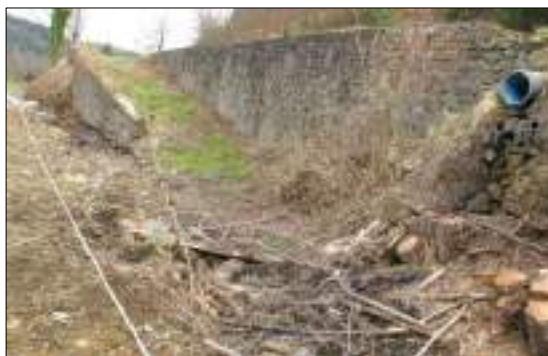
Photo 12 : Déversement des eaux pluviales de la route départementale dans le béal (arasé au cours des travaux), et indication de la limite de la parcelle du béal par un ruban blanc (sur la gauche de la photo).
