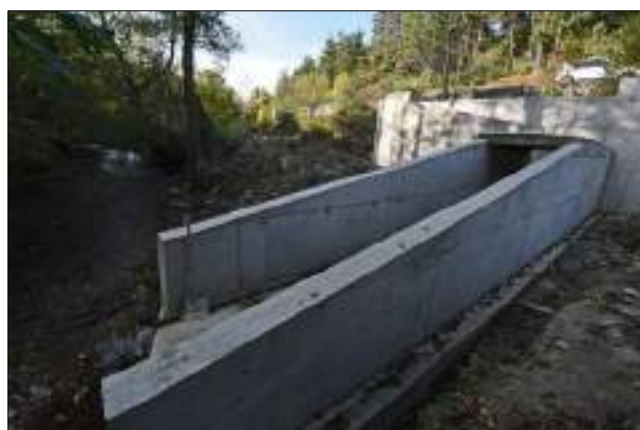
Photo 6 : Déversoir donnant sur la Desges à gauche et dégrilleur le 13 octobre 2017.
