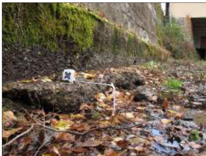
Photo 42 : Creusement naturel du béal aval de 10 à 16 cm hors sol cimenté à proximité des parcelles AE 241 et 242.
