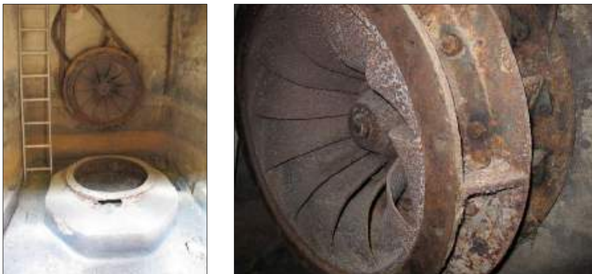
Photo 1 : État de la turbine du moulin amont en 2015.
