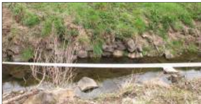
Photo 38 : Au centre de la photo, muret vertical en rive droite du béal en assez bon état, et à droite état après écroulement du muret.
